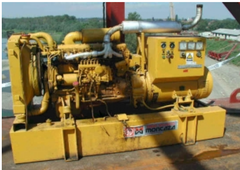
Slika 4.12 Fotografija agregata za proizvodnju struje
